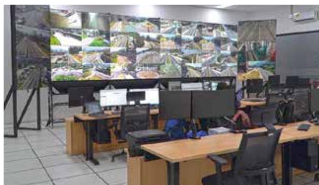
Fotografía.2 Sala de comunicaciones – CCO Caldas
