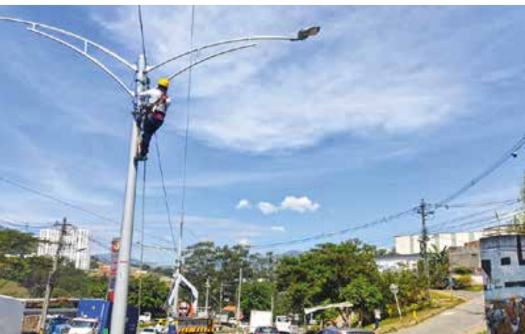
Fotografía 6. Iluminación Variante Caldas
