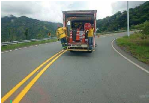
Demarcación horizontal y Marcas viales
