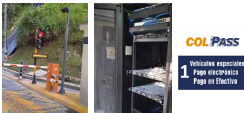
Figura 9. Nuevos Equipos en la Estación de Peaje Amagá
