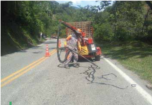
Sello de Fisuras
